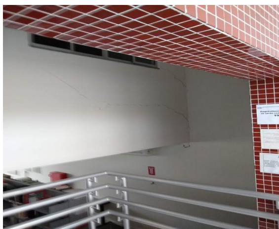
figura 03: rachadura na estrutura
