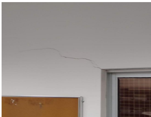
Figura 05: rachadura na estrutura
