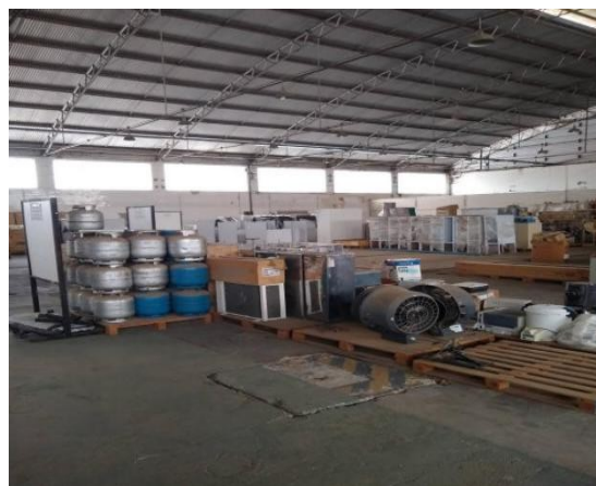
figura 02: piso irregular e pontos de goteiras
