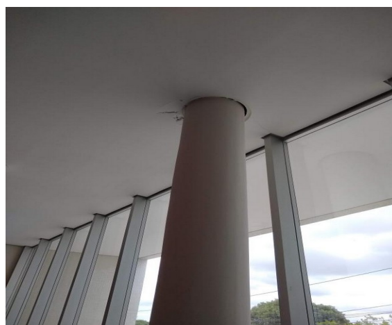
figura 04: rachadura na estrutura
