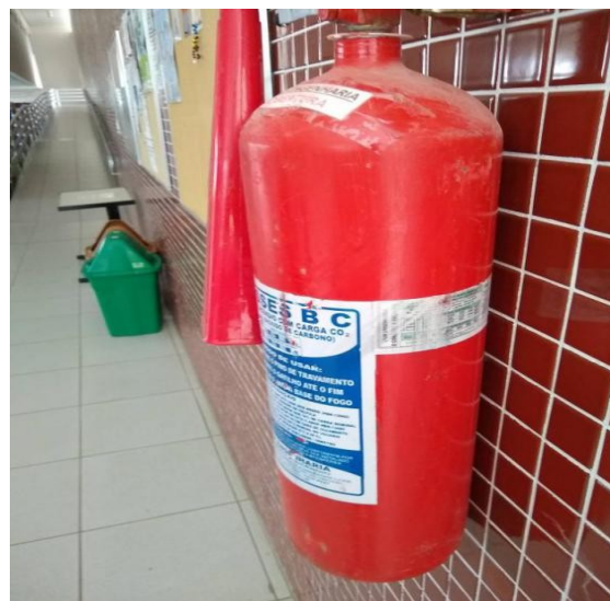
figura 33: extintor de incêndio vencido 02
