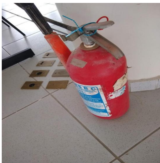
figura 32: extintor de incêndio vencido 01
