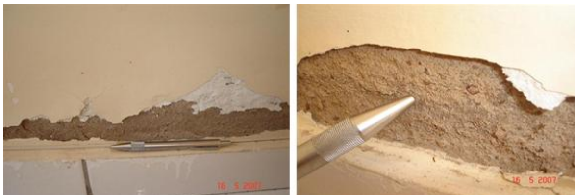
Figura 1 - Revestimentos de alvenaria deteriorados.
