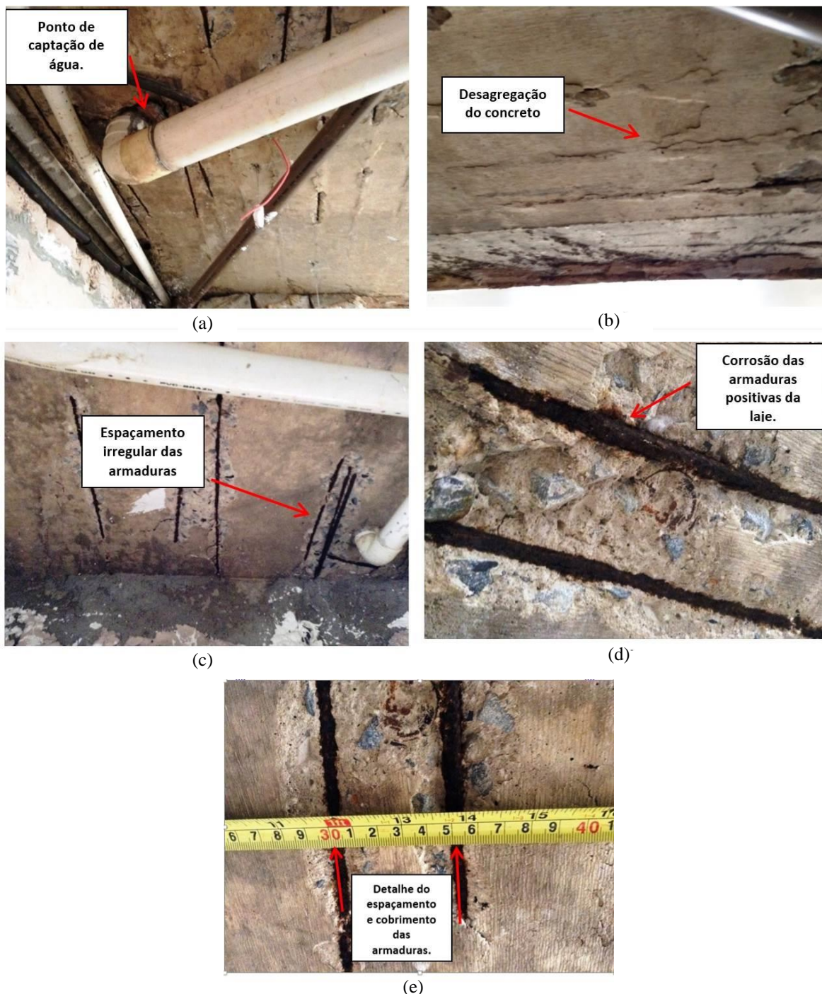
Figura 4 - Detalhe das manifestações patológicas encontrada na Área 1
