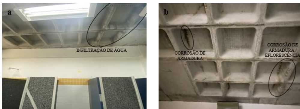
Figura 6 – Laje F1 - a) infiltração de água; b) corrosão de armadura e eflorescência.
