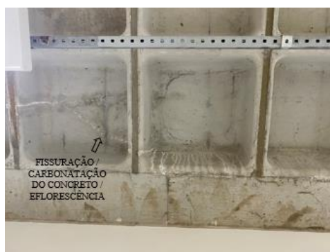
Figura 9 – Laje F12 - fissuração, carbonatação do concreto e eflorescência.
