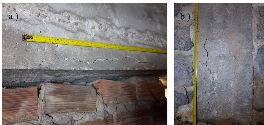
Figura 10. a) Fissura em elemento de viga (V1);b) Fissura em pilar (P13).
