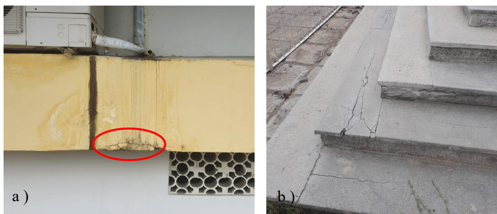
Figura 19. a) Manchas e segregação na parte inferior da viga V1 devido a drenagem incorreta do ar condicionado; b) Escadaria da parte frontal da igreja com presença de fissuras.
