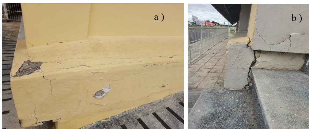
Figura 18. a) Viga V5 em estado alto de degradação. b) Rompimento do suposto elemento arquitetônico da fachada (Viga V1).
