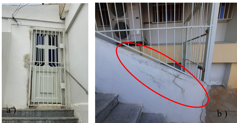
Figura 20. a) Degradação ao redor da porta da secretaria; b) Fissura no guarda corpo da escada.
