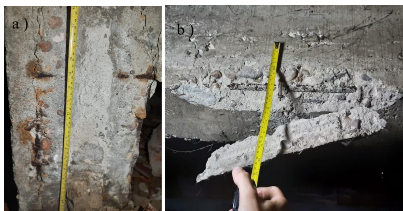
Figura 15. a) Desagregação pilar P18 devido a umidade e corrosão da armadura; b) Placa de concreto solta na viga V2.
