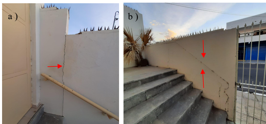
Figura 21. a) Fissura no encontro do pilar com o muro; b) Fissura entre a parede existente com o complemento construído posteriormente.
