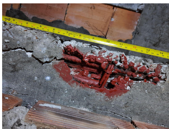
Figura 12. Viga (V1) com presença de vazio de concretagem.
