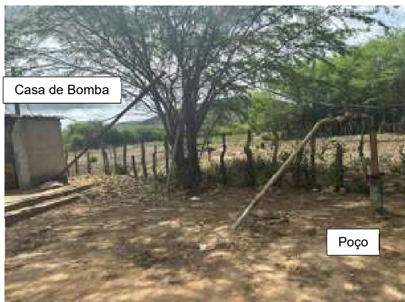
Figura 68 — Casa de Bomba e Estação Elevatória de Água de Lage de Cima I
