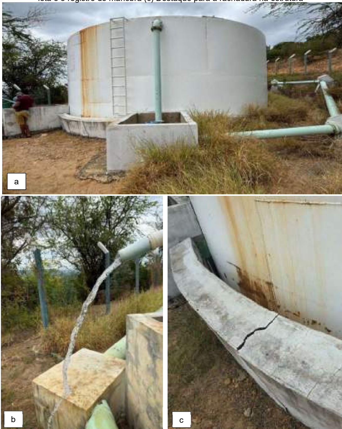
Figura 71 — (a) Vista do reservatório apoiado de Lage dos Negros. (b) Tubulação da 1ª coleta e o registro de manobra (c) Destaque para a rachadura na estrutura
