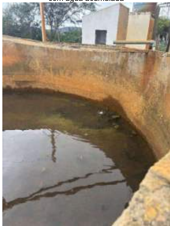
Figura 54 — Reservatório apoiado desativado com água acumulada
