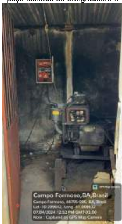
Figura 41 — Casa de máquina do poço fechado de Sangradouro II
