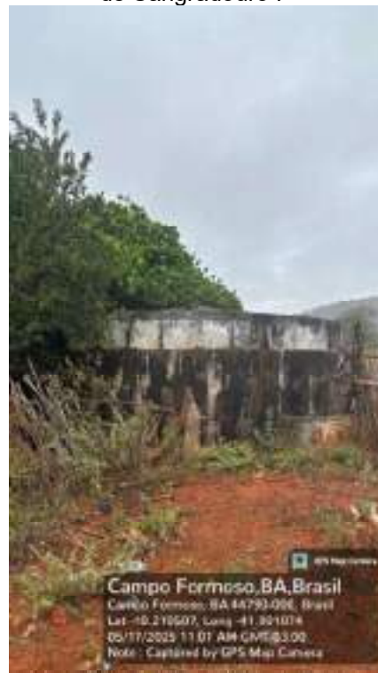
Figura 37 — Reservatório apoiado de Sangradouro I
