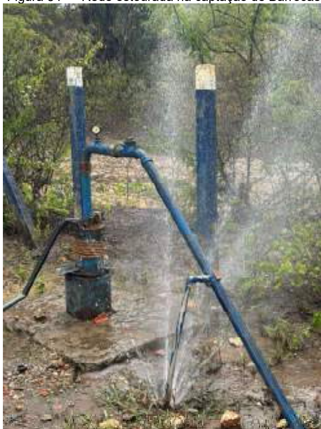
Figura 34 — Rede estourada na captação de Barrocas
