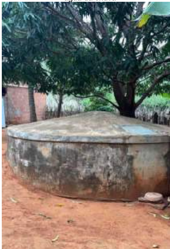
Figura 84 — Cisterna de armazenamento de água da chuva
