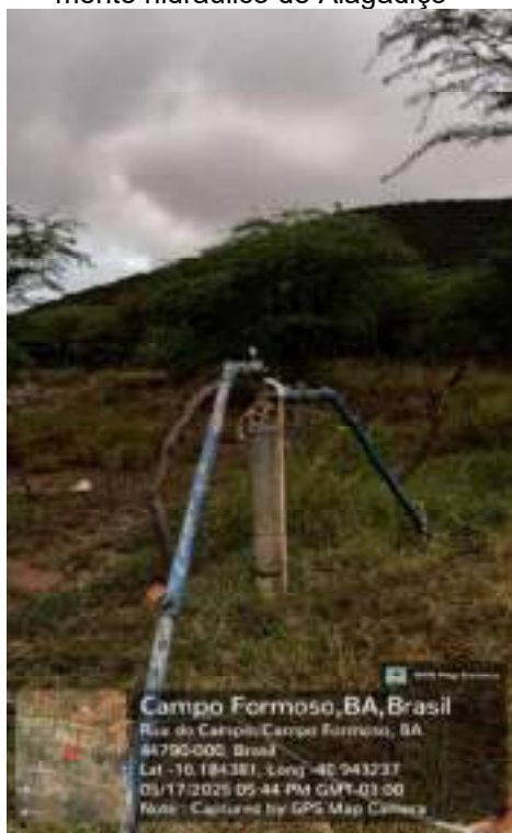
Figura 79 — Dispositivo de bombeamento hidráulico de Alagadiço
