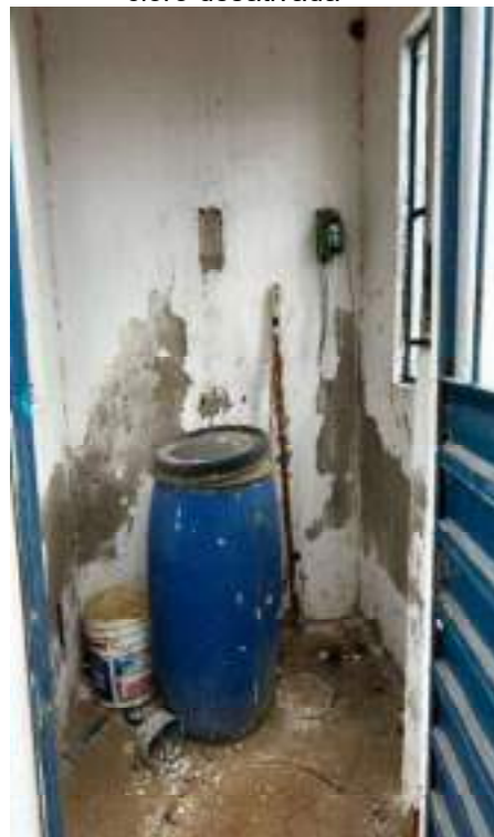
Figura 50 — Bomba dosadora de cloro desativada
