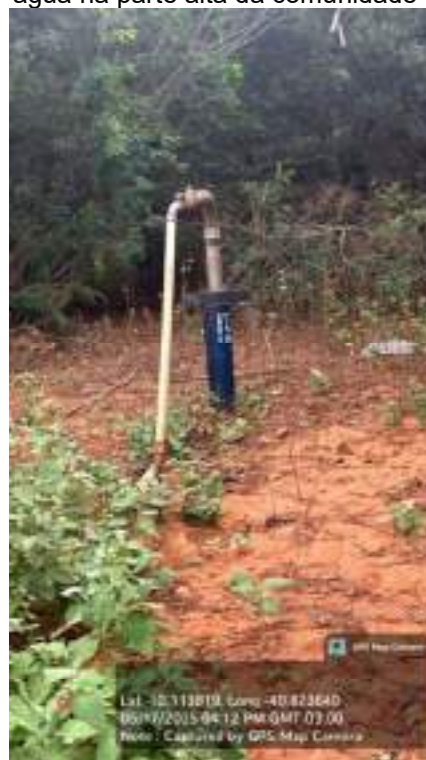
Figura 25 — Poço que distribui água na parte alta da comunidade
