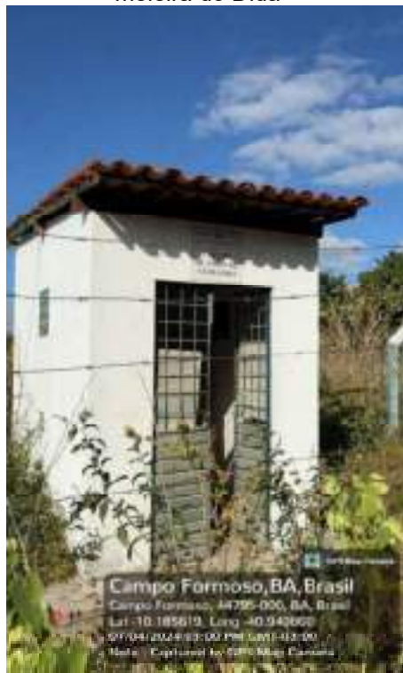
Figura 49 — Casa de cloro de Gamaleira do Dida
