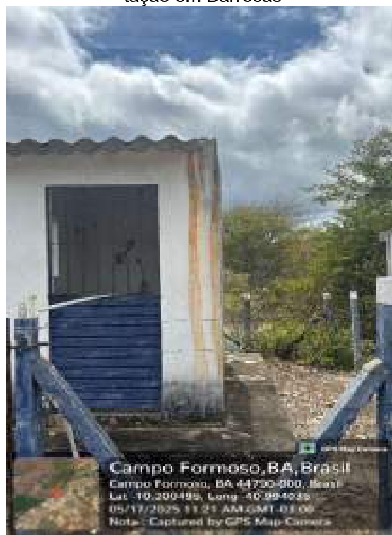
Figura 33 — Casa de bomba do poço de captação em Barrocas
