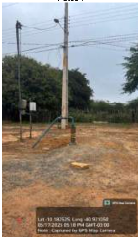
Figura 55 — Estação Elevatória de Patos I
