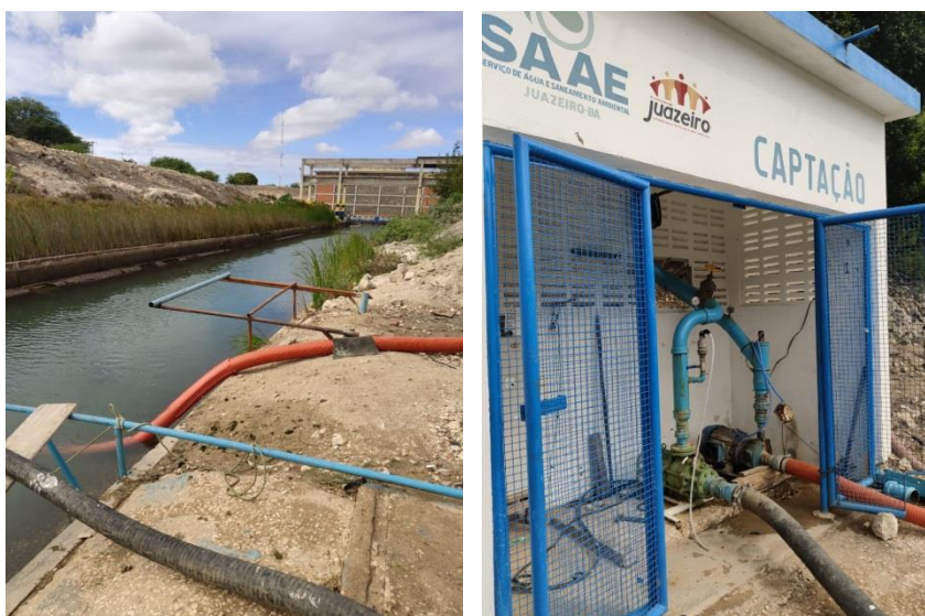
Figuras 7 - Captação de água bruta em Carnaíba (Car)
