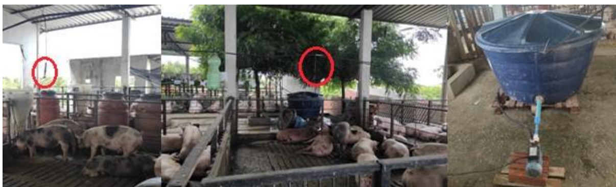
Figura 12 - Sistema de microaspersão com os aspersores nas baias de aspersão e aspersão com ventilação e motobomba interligada a caixa d'água que distribuía a água para os conectores.
