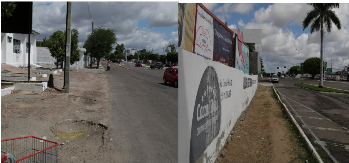
Figura 13 - - Passeio esburacado (esq.) e sem pavimentação (dir.) na Av. Apolônio Sales
