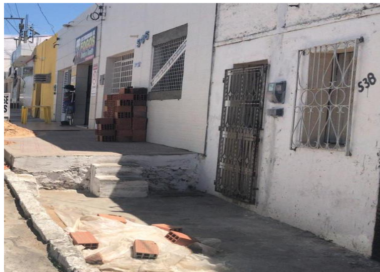
Figura 14 - Obstáculos e desnível entre calçadas na Rua Manoel Novaes
