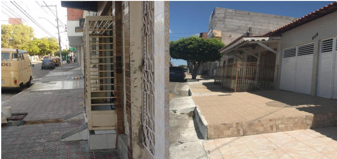
Figura 15 - Grade invadindo o passeio na Av. Getúlio Vargas (esq.) e na Av. da Maçonaria (dir.)
