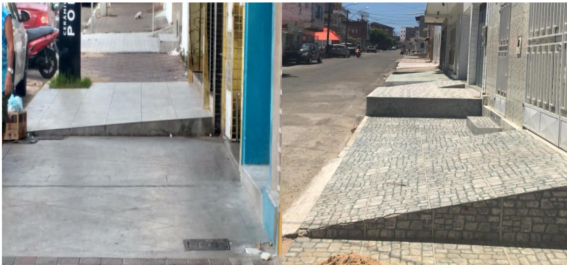
Figura 11 - Desnível entre calçadas na Av. Getúlio Vargas (esq.) e na Av. da Maçonaria (dir.).
