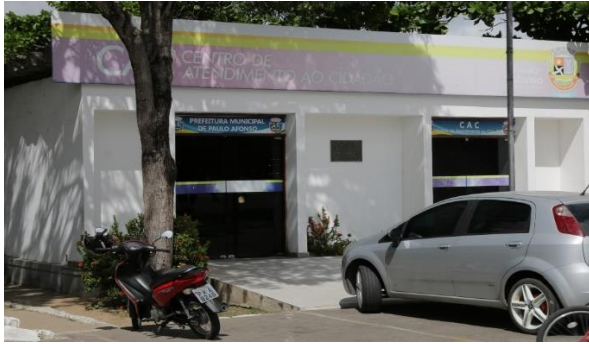
Rampa de acessibilidade obstruída na Prefeitura.
